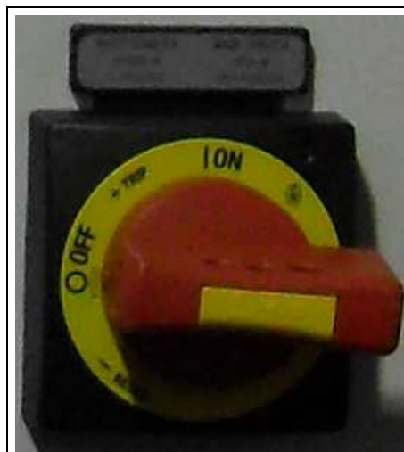
Fig. 7: dispositif de sectionnement du réseau
