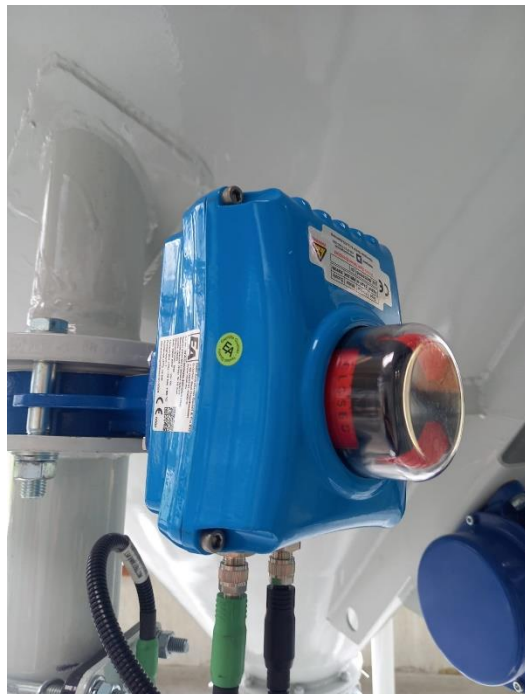
Das Absperreklappe ist komplett geschlossen („closed“ – rot)
